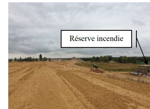
Vue Nord Sud – Bordure Ouest des casiers I à V – Source EACM,
